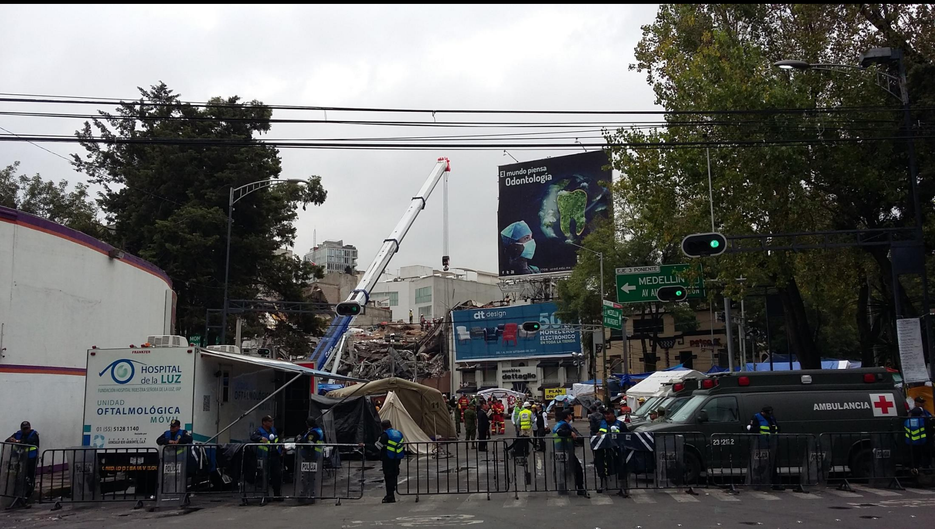
Derrumbe en Álvaro Obregón 286
