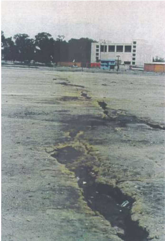
Grietas en la Calz. I. Zaragoza -Santa Martha Acatitla (Orilla del Lago)
