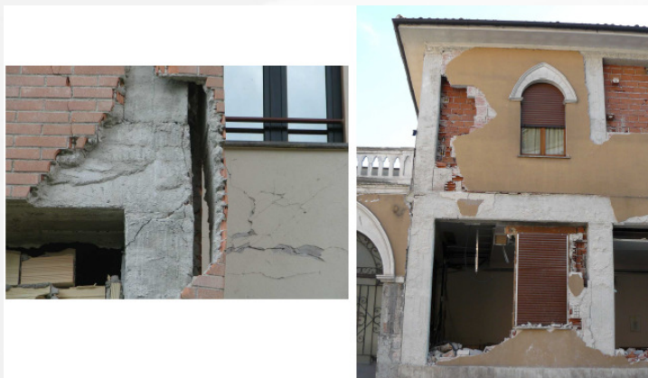
Figura 3. Daños por desprendimiento de revestimiento de fachada (der) y vaciamiento de paneles de albañilería de relleno (izq), en la ciudad de L'Aquila. Fuente: Oyarzo Vera & Griffith, 2009
