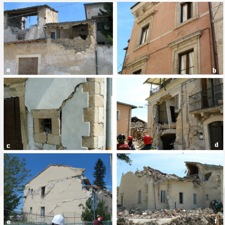
Figura 2. Principales daños en Villa San Gregorio (a, b y c) y Villa Onna (d, e y f), ocurridos durante el sismo del 6 de abril de 2009. Fuente: Oyarzo Vera & Griffith, 2009
