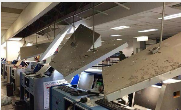
Figura 2. Daños en el Aeropuerto Internacional de Tapachula. Fuente: www.24-horas.mx
