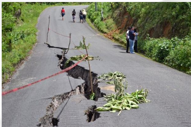
Figura 4. Daños en tramos carreteros, Unión Juárez Fuente: www.jornada.unam.mx
