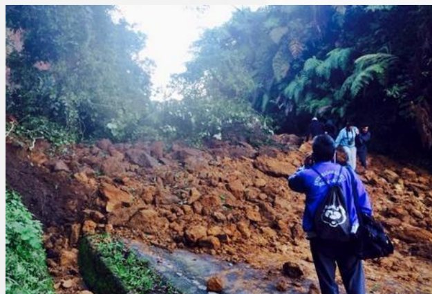
Figura 7. Derrumbe en la vía Colomba-San Juan Ostuncalco, Quetzaltenango, Guatemala. Fuente: www.prensalibre.com
