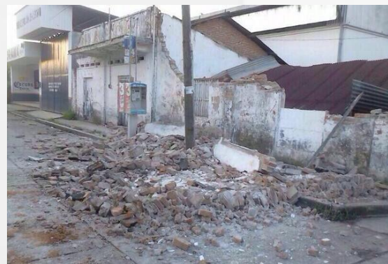
Figura 3. Daños en viviendas, Chiapas Fuente: www.prensalibre.com
