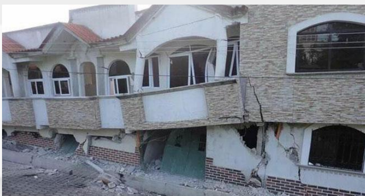
Figura 5. Viviendas afectadas por sismo en San Marcos, Guatemala. Fuente: www.prensalibre.com
