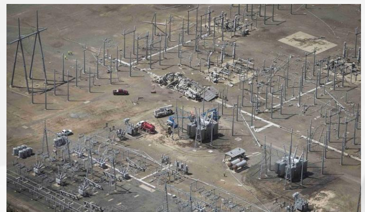
Figura 3. Daños en una estación eléctrica ubicada en Mayflower, Arkansas. Fuente: Carlo Allegri/Getty Images.
