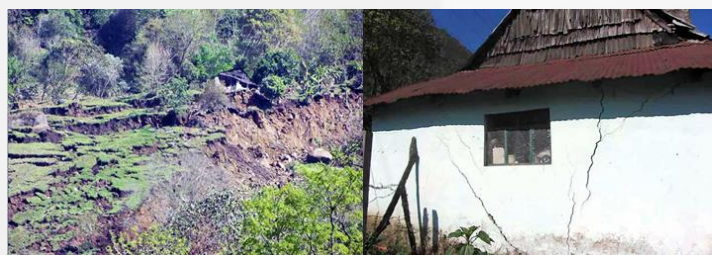
Figura 3. Daños ocasionados derrumbe del cerro. (Fotos: Reforma)
