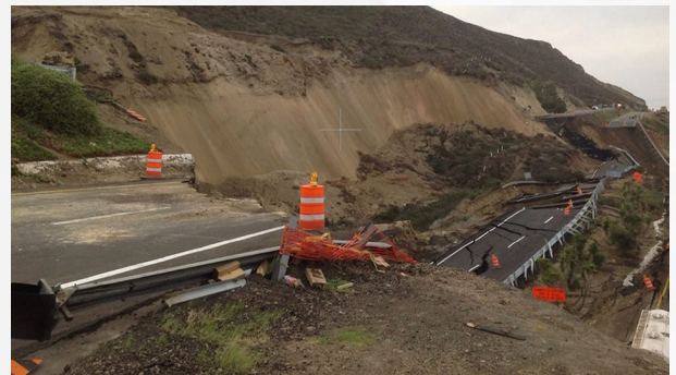
Figura 3. Daños ocasionados a carretera por derrumbe (Foto: CNN México)
