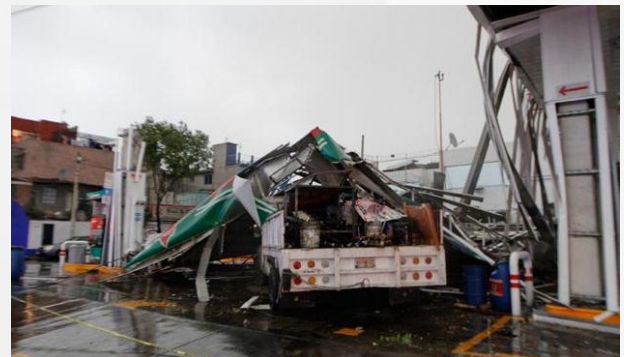
Figura 3. Daños presentados en estructuras ligeras. Fuente: Foto de Luis Carbayo, www.cuartoscuro.com
