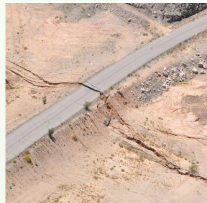
Figura 2. Vista de ruptura en superficie en la carretera federal 2 (foto tomada por geólogos del CICESE (CICESE, 2010)).
