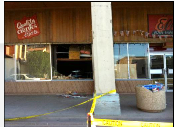
Figura 2. Daños en Brawley, California
