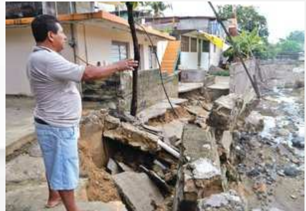
Figura 5. Afectaciones en el municipio de Coyuca de Benítez, Guerrero.
