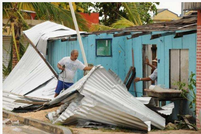
Figura 3. Algunos de los daños reportados en Quintana Roo fueron principalmente en viviendas de cubierta ligera
