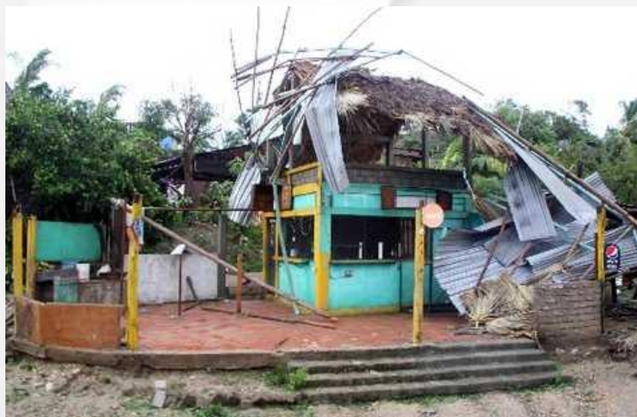
Figura 3. Dentro de los principales daños reportados, se encuentra el desprendimiento de techos ligeros
