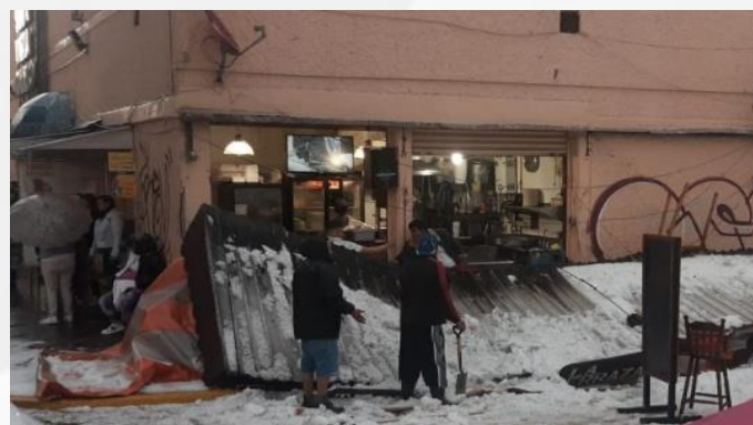
Figura 3. Daños en el mercado de Santa María Nonoalco. Fuente: @SGIRPC_CDMX
