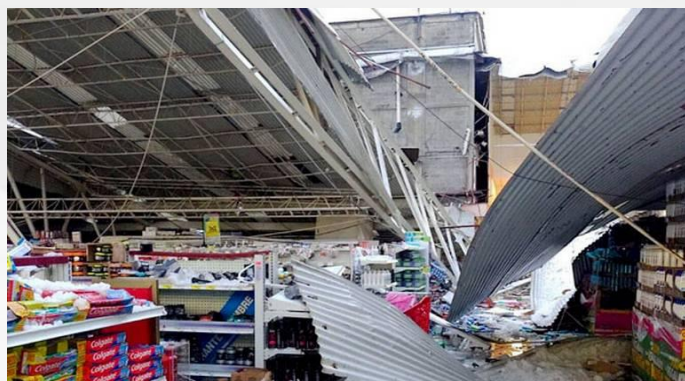
Figura 1. Desplome del techo del supermercado Mega Soriana Mixcoac
