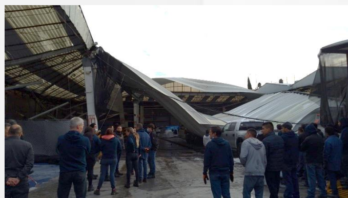
Figura 2. Desplome parcial de la cubierta de taller Fuente: Twitter@SGIRPC_CDMX
