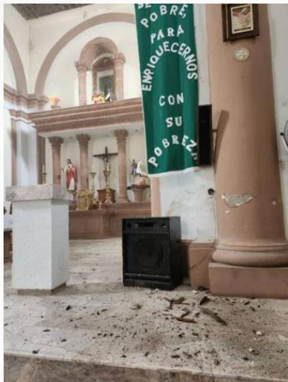
Figura 5. Daños en el templo de Santiago Apóstol, Michoacán.
