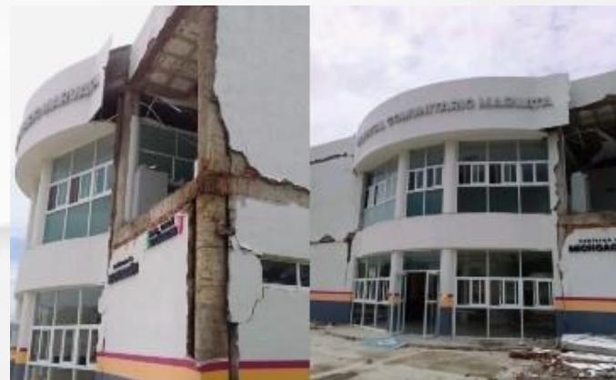
Figura 2. Daños en el Hospital Comunitario Maruata.
