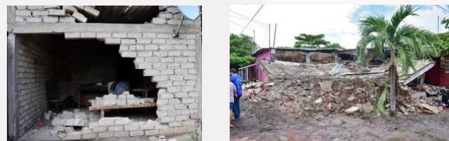
Figura 3. Daños en muros de mampostería y colapso de una vivienda.
