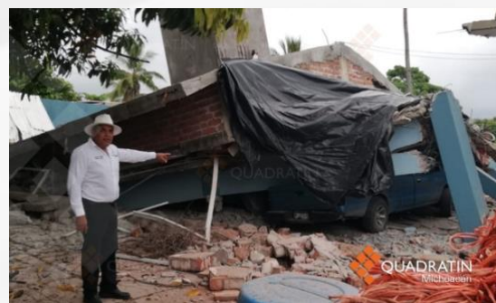
Figura 4. Colapso de una casa de concreto reforzado.
