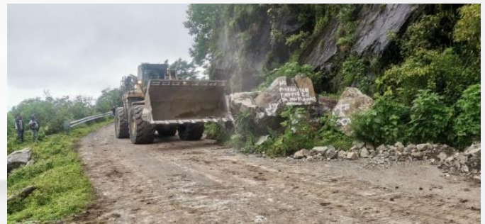
Figura 7. Caída de rocas en la carretera Coalcomán-Aquila.
