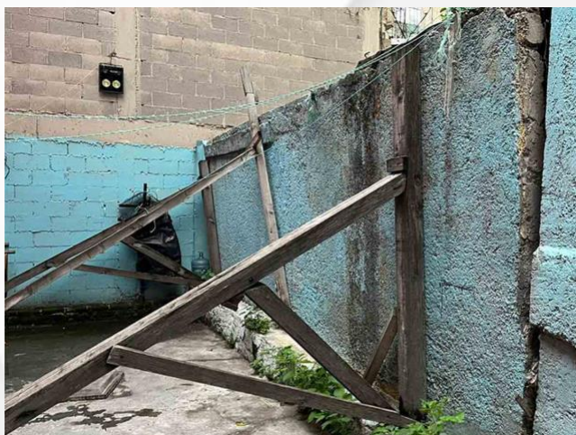
Figura 9. Barda a punto de colapsar en Dr. Navarro No. 182, Cuauhtémoc.
