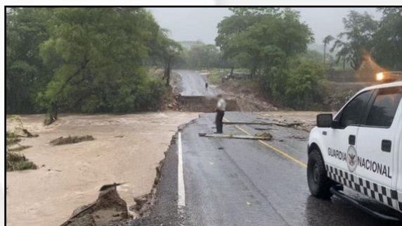
Daños en el sector carretero (Colima)
