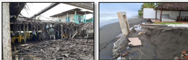
Daños en comercios (Colima)
