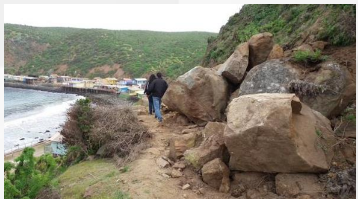
Figura 4. Daños en caminos y accesos Fuente: Usuario de twitter
