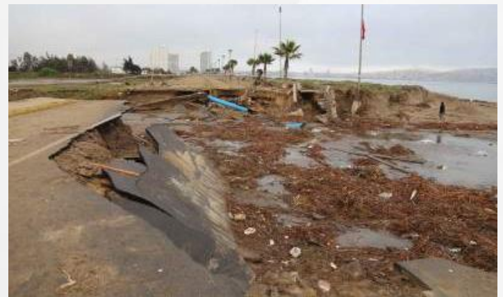
Figura 3. Daños en Avenida Costanera de Coquimbo Fuente: Diario El Observa Todo
