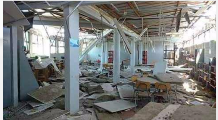
Figura 2. Daños en El Colegio Médico de Coquimbo Fuente: Noticias t13
