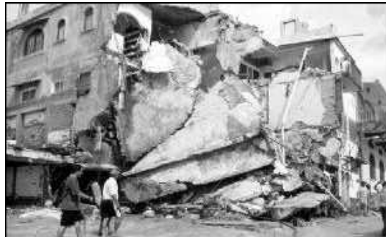
Figura 3 Casas habitación y algunos hoteles frente a la costa fueron dañados severamente en sus estructuras por el impacto del oleaje y por socavación. (Foto: La Jornada)
