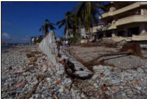
Figura 2 El muro de concreto armado, de aproximadamente 2 metros de alto, que rodeaba al hotel Sheraton, falló a todo lo largo del costado sur del edificio, pero evitó que el oleaje incidiera directamente sobre la estructura. El agua inundó completamente los primeros pisos. (Foto: ERN)
